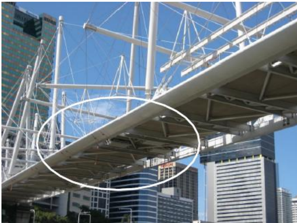
Fot.41. Tłumiki (tuned mass dampers) umieszczone na środku głównego przęsła [1]
